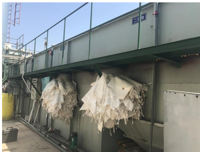
图 4-2 污水处理设施
